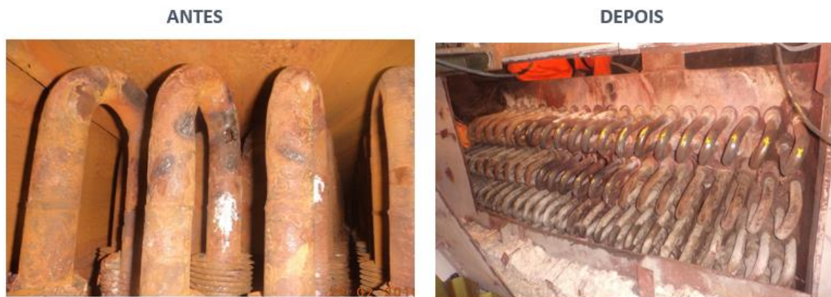
Figura 7. Economizador da Caldeira
