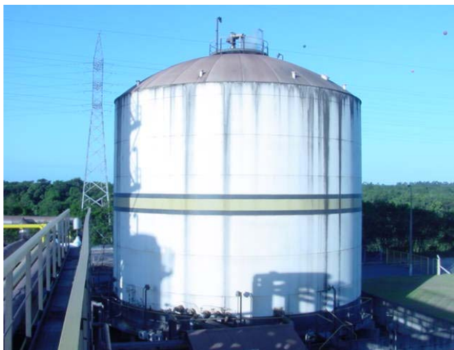
Figura 3. Tanque de estocagem DR-450.
