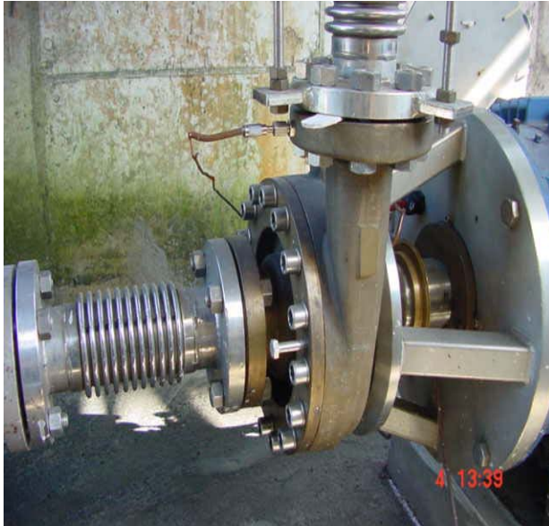
Figura 4. Bombas de envio.
