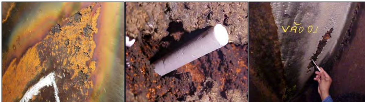
Figura 1. Erosão Cavitacional em Turbina Francis.
