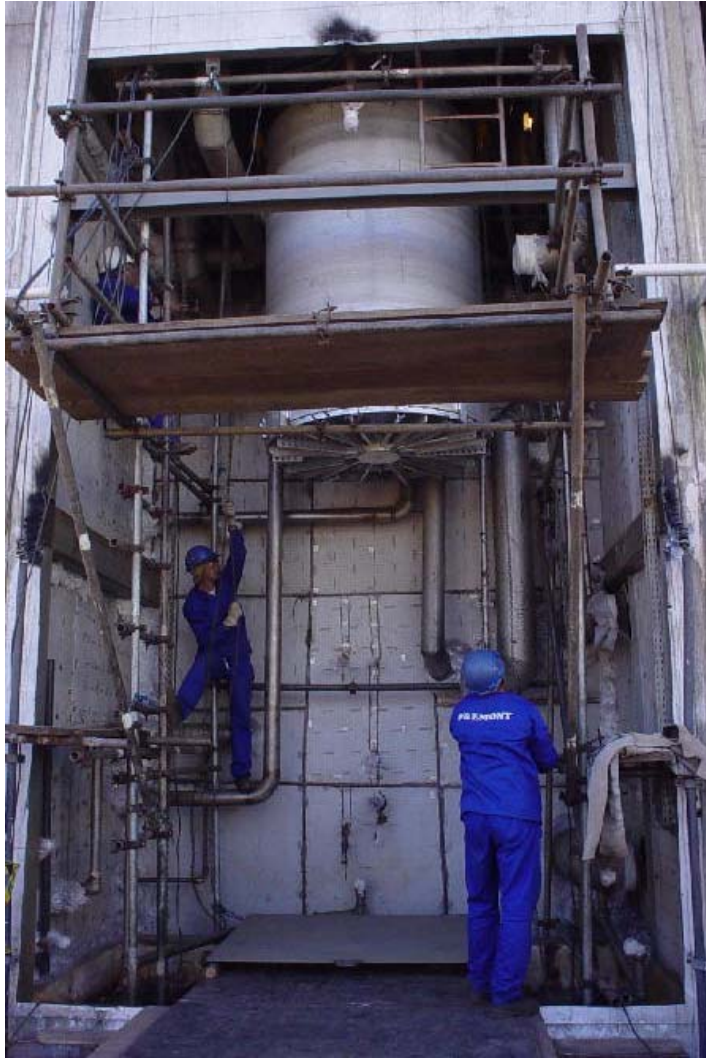
Figura 2 - Içamento da Nova Seção Superior da Coluna Completa dentro da Caixa Fria
