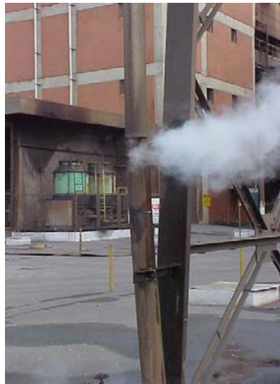
Figura 5. Vazamento de vapor.
