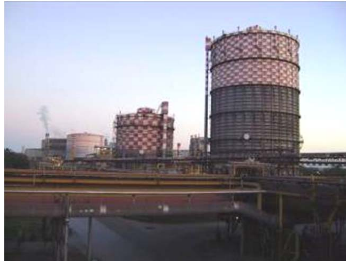
Figura 3. Gasômetros de BFG, COG e LDG
