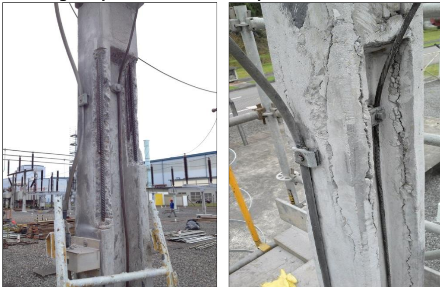
Figura 7: Estruturas avariadas aguardando reparo
