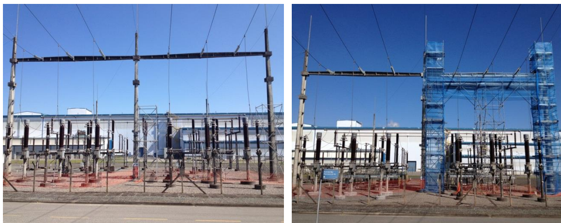
Figura 5: Pórtico de Entrada com as duas Linhas de 230kV
