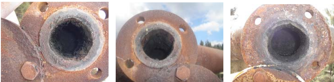
Figura 6 Inspeção realizada após término do teste. 50m do aquecimento dos carros torpedo.
