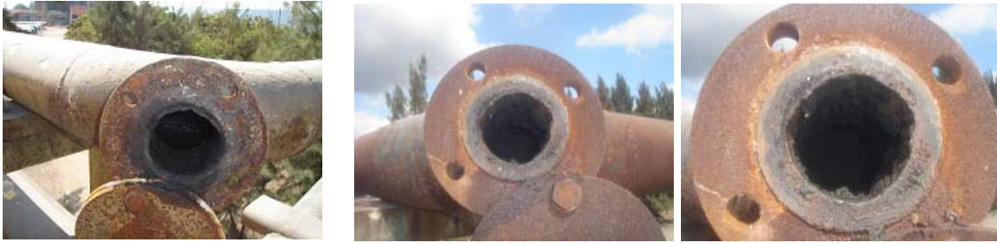
Figura 4. Inspeção realizada após término do teste. Flange localizado a aproximadamente 200m do aquecimento dos carros torpedo.
