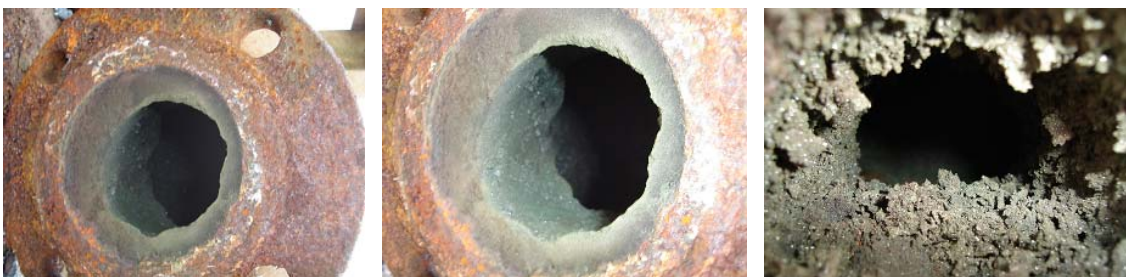
Figura 7 Inspeção realizada antes do início do teste. Janela de visita aberta na tubulação para inspeção do antes e depois do teste.
