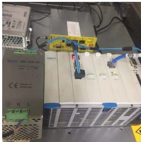
Figura 1. PLC's FESTO instalados em plataforma de testes da Automação
