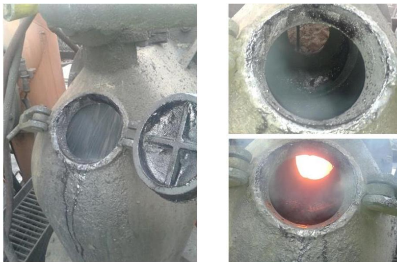
Figura 5 – Vista do interior do “gooseneck” de um forno da Bateria # 1 com a adição do catalisador, sem a presença de depósito de material (obstrução).
