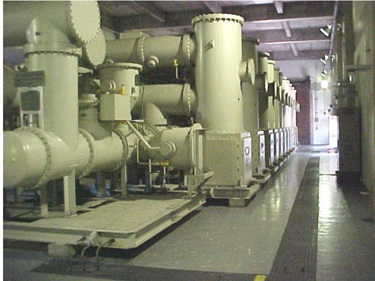
Figura 2 – Vista dos Módulos Blindados da ER 1
