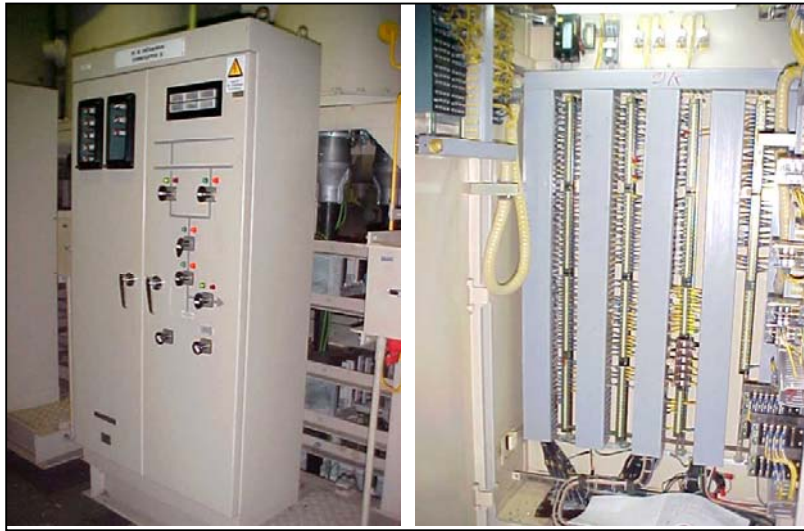
Figura 5 – Painel de Comando
