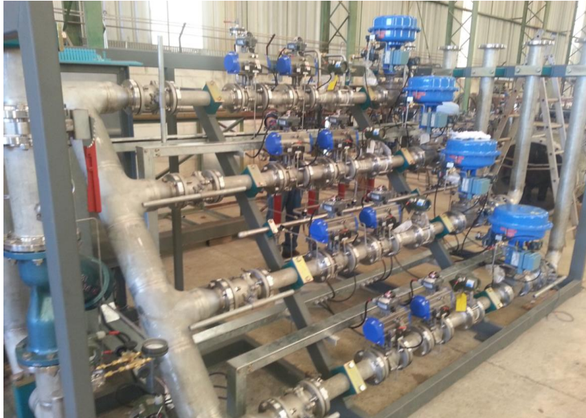
Fig. 3-f - Rack de válvulas (Skid)
