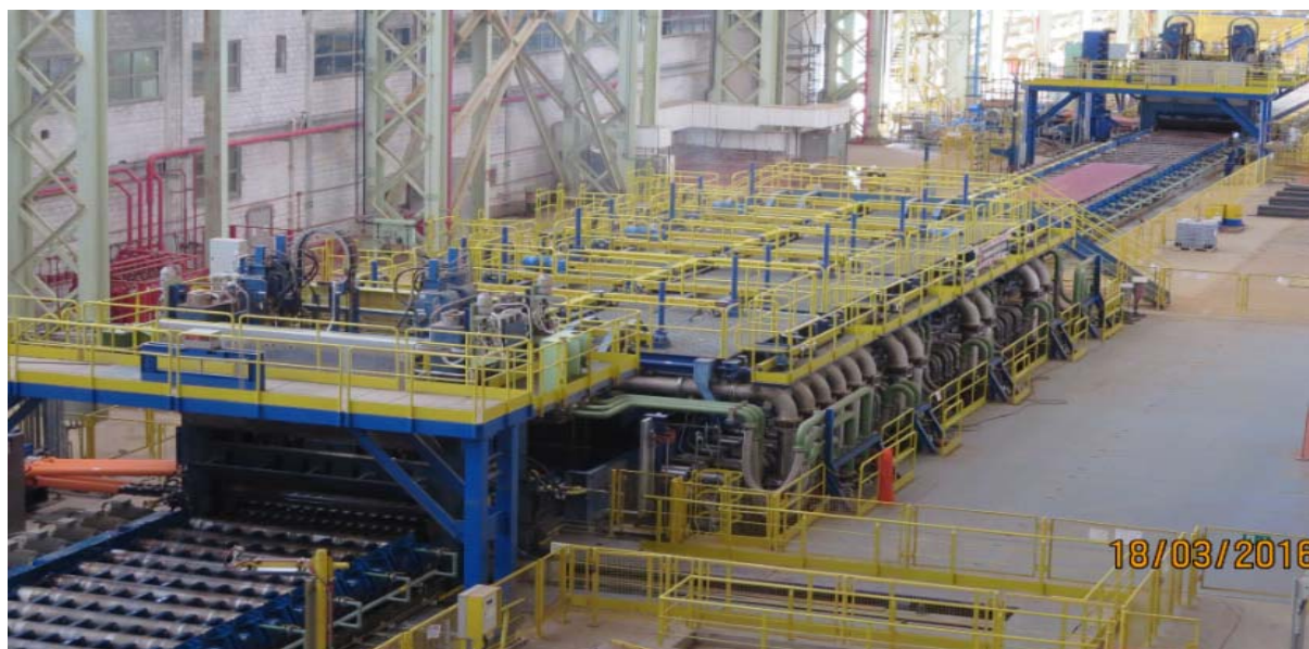
Figura 7 – Pré Desempenadeira junto ao Sistema de Resfriamento
