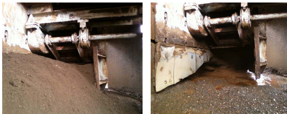
Figura 5. Detalhe da descarga do Table Feeder . Fonte: Autor.
