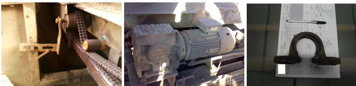
Figura 7. (a) Detalhe do tensionador da corrente; (b) Acionamento da correia transportadora da balança; (c) Mancal do Tambor de retorno avariado. Fonte: Autor.
