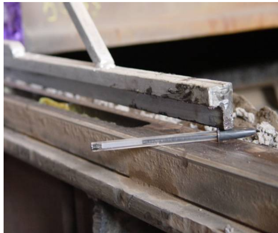
Figura 5 – Desnivelamento das vigas de apoio das réguas de selagem da máquina de sinter com inserção de cerâmica
