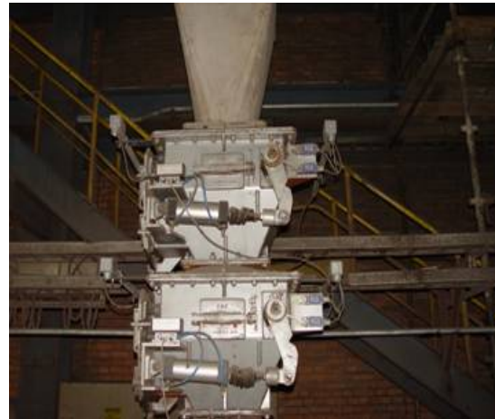
Figura 7 – Válvulas duplo-cone modelo atual (acionamento pneumático)
