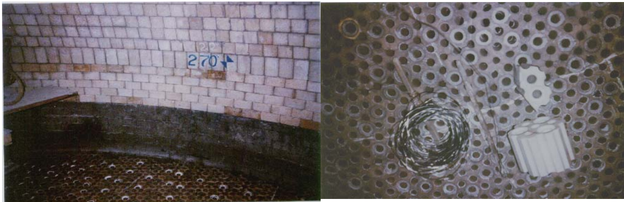
Figura 5 - Foto interna do revestimento refratário "Tipo Colmeia".
