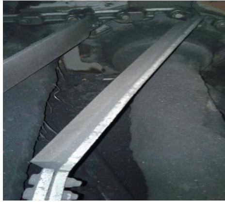
Figura 3 - mostrando o tracionamento com apenas um dos lados da corrente
