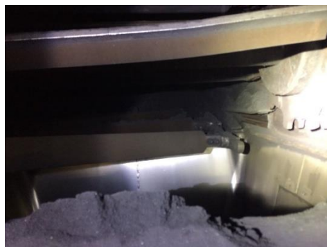
Figura 2 - apresenta as barras de tração tortas e o rompimento da corrente.
