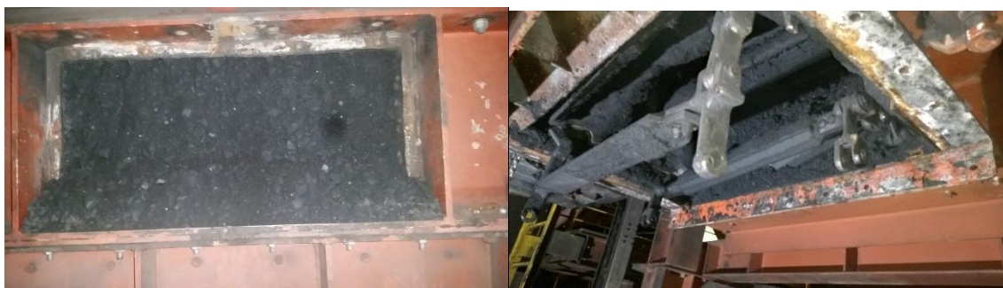
Figuras 9 e 10 imagem da janela de visita e tampa inferior da corrente do transportador apresentando excesso de finos aglomerado.
