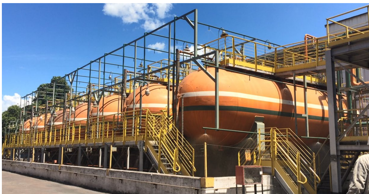
Figura 9 - Vista dos sete tanques com sistema de spray de neutralização instalado.
