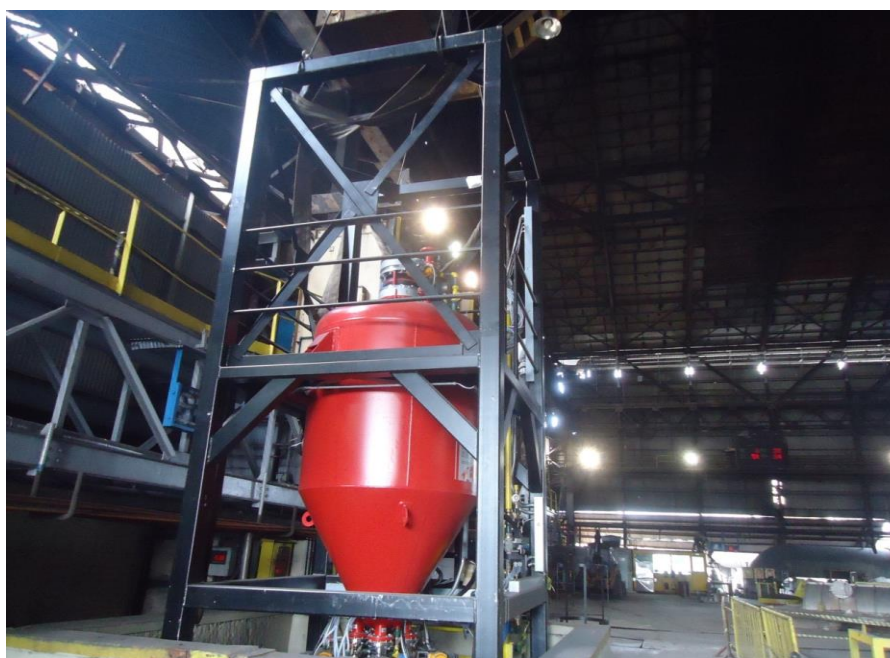
Figura 5 – Instalação modular na sala de corridas do Alto-forno 3 da CSN
