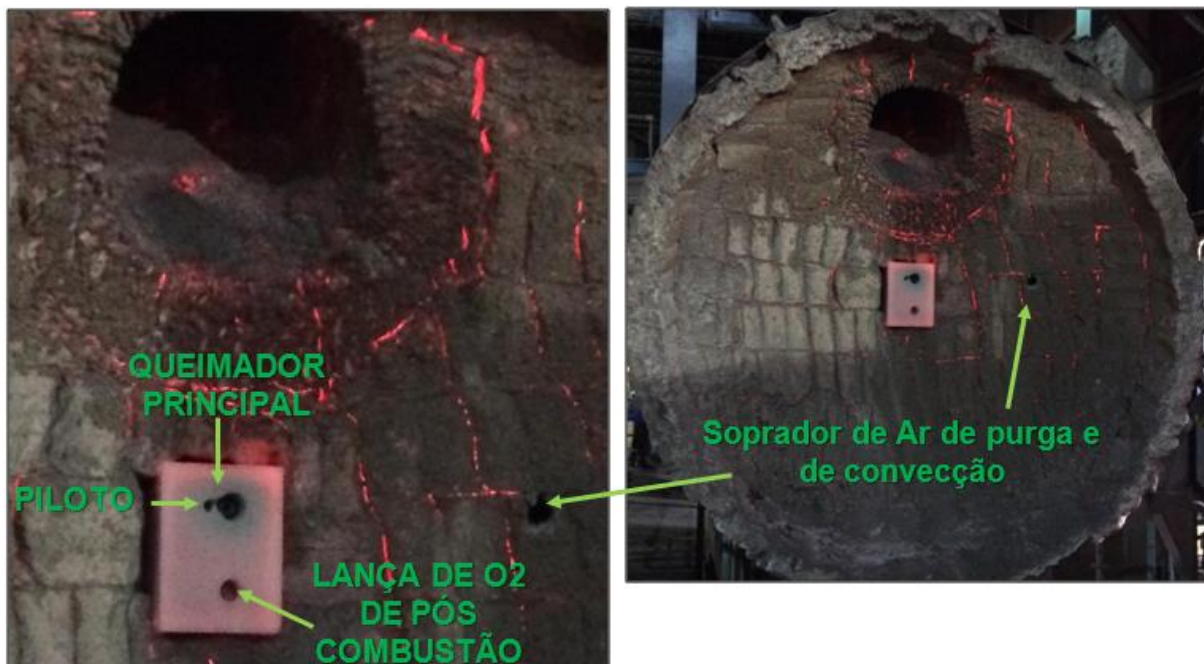
Figura 2.f – Vista da face quente do aquecedor de painelas
