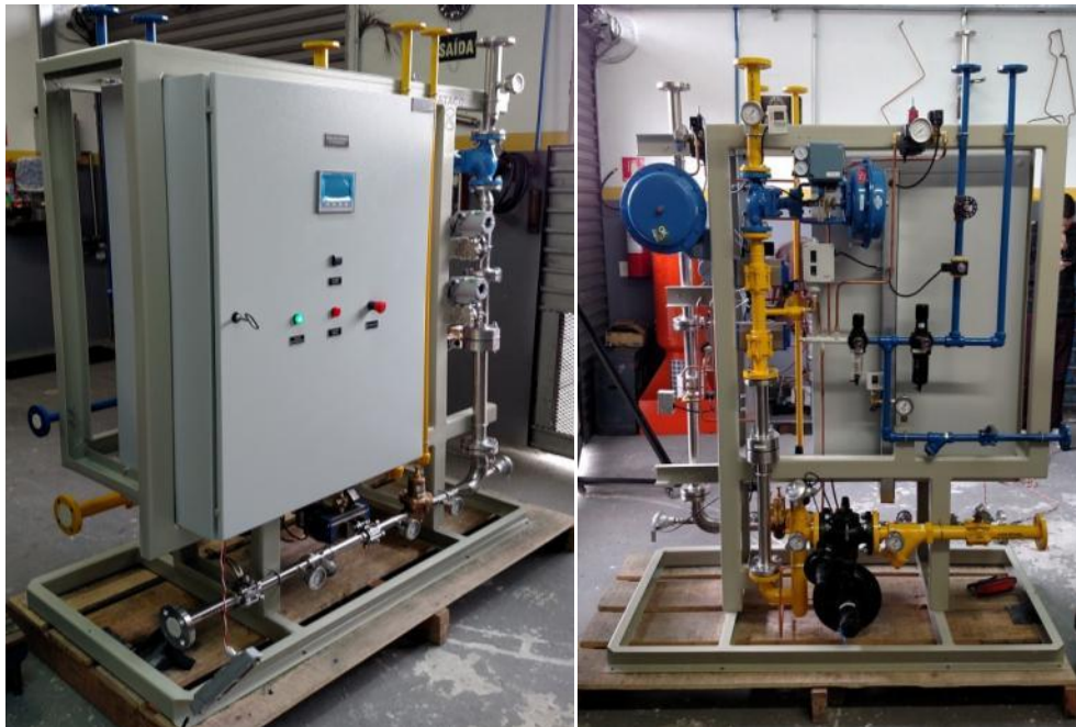
Figura 2.g – Skid de válvulas para controle
