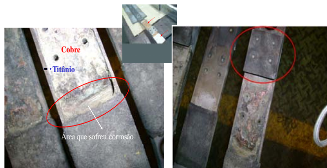
Figura 9 – Corrosão e carbonização no contato elétrico do anodo insolúvel.
