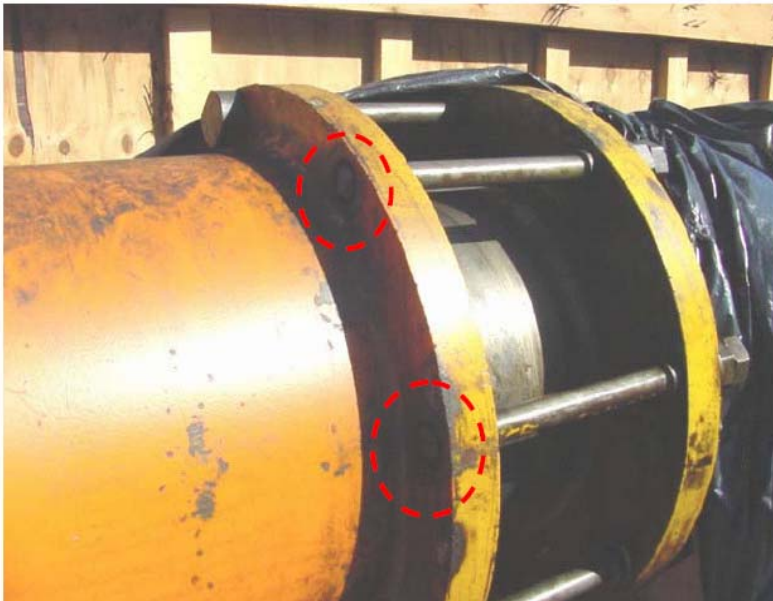
Fig. n° 03: Fratura na região da cabeça dos tirantes.
