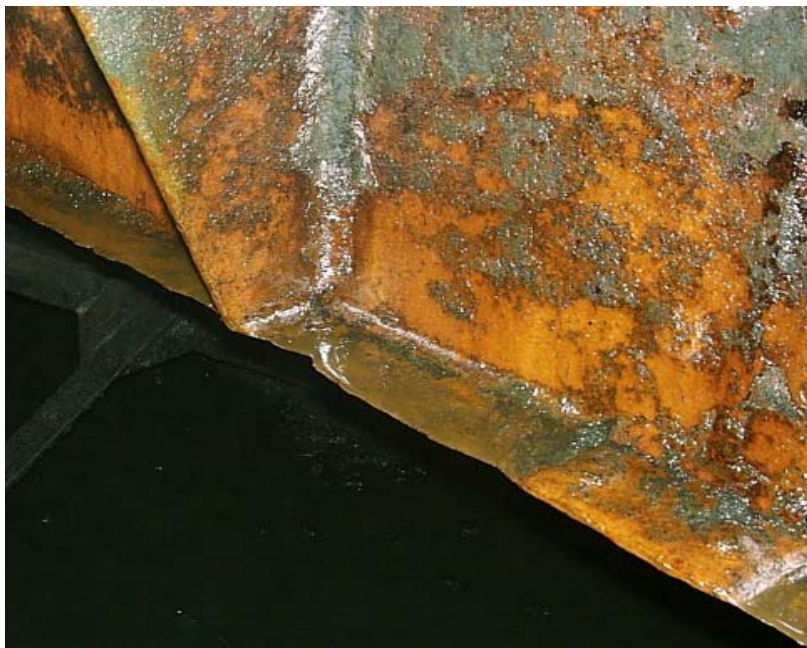
Figura 4. Corrosão na chaparia do “footring”. As chapas metálicas apresentam desgaste, redução de espessura e depósitos de material.
