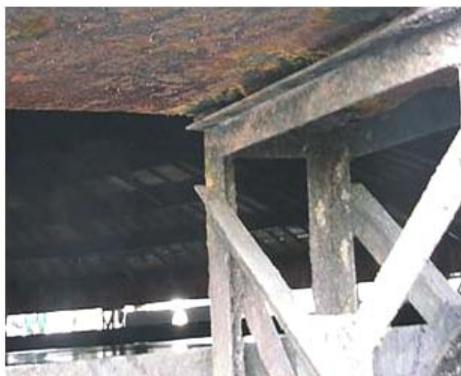
Figura 2. Corrosão nas estruturas de apoio do pistão (cavaletes) e na parte inferior do anel de sustentação do concreto (“footring”)
