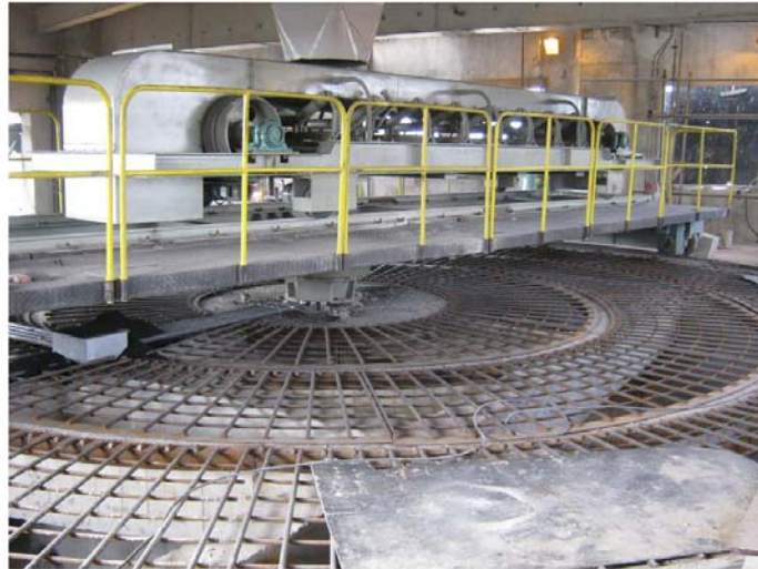
Figura 6. Distribuidor rotativo do coal bunker .
